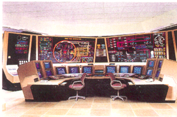
Sala controllo di tipo innovativo
