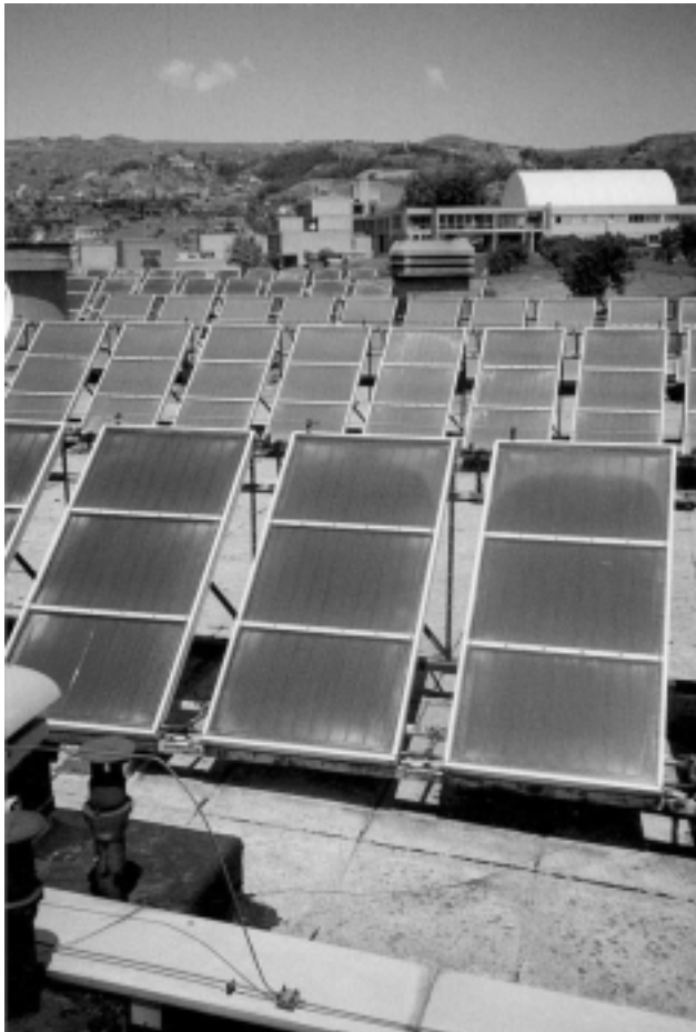
Figura 2.9 - Pannelli solari su tetto piano (Istituto Alberghiero - Potenza).
