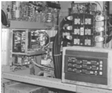
Figura 3.16 - Uno degli inverters della centrale fotovoltaica ENEL di Serre (SA).
